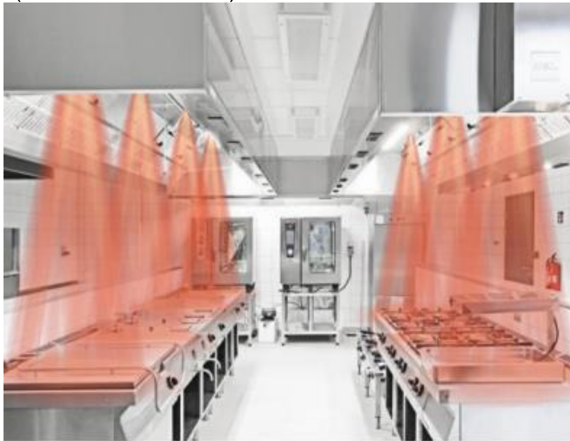
Haltons behovsstyrning med IR-sensorer, VAV (Variable Air Volume)
